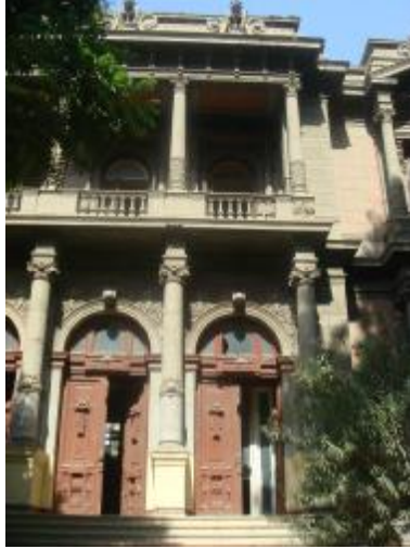
(شكل ٦) قصر سعيد حليم بشارع شمبليون في حاجة إلى ترميم وإعادة توظيف لاستعادة حالته الأصلية
