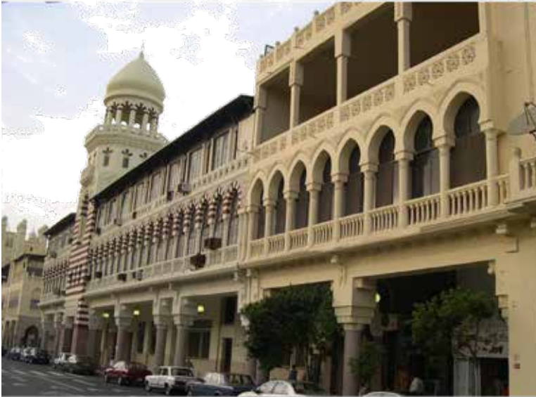
(شكل 15) مباني مصر الجديدة - الكورية - شارع بغداد طراز معماري متميز مباني تراثية فئة (أ) تحتاج إلى ترميم مع عدم إجراء أى تعديلات داخلية أو خارجية إلا فى أضيق الحدود
